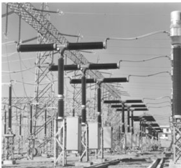
Figura 3.6 Interruptores monopolares en SF 6 [28].
